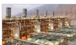
نیروگاه گازی عسلویه
