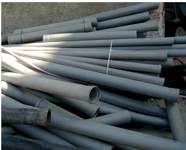
نحوه انبارش نادرست
